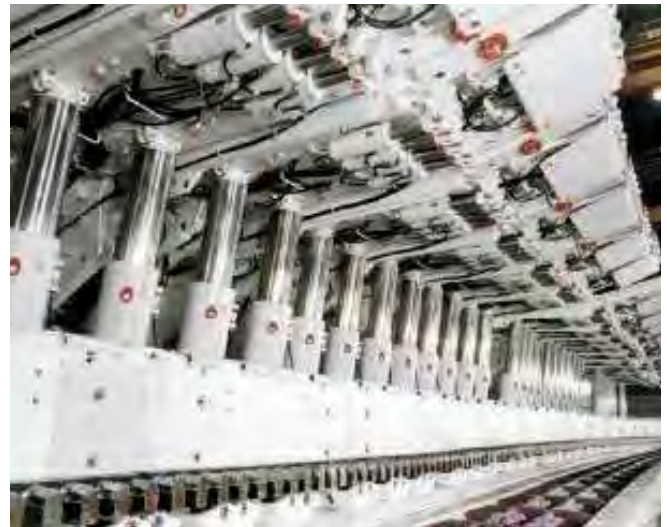
Bild 14: Strebausbau mit Hydraulikschilden
