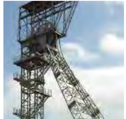
Bild 20: Strebenfördergerüst aus Stahl
